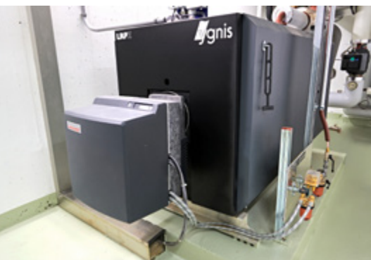
Der neue kondensierende Weishaupt-Ölbrenner WL 30 kam 2021 dazu.
