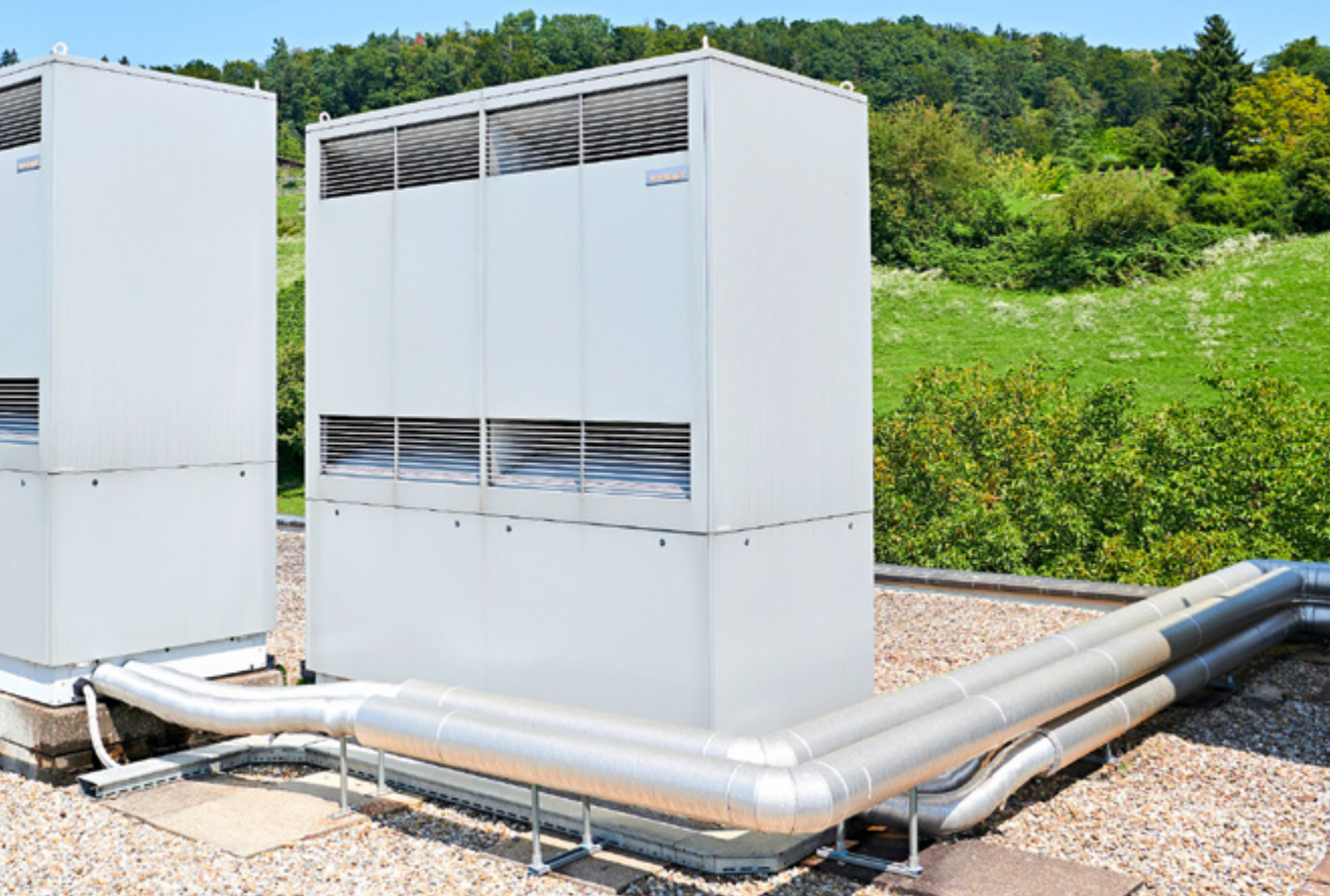
Die 2018 aufgestellten Aussengeräte der bivalenten Heizanlage laufen mit ihren Radial-Ventilatoren sehr leise.
