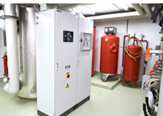
Die Hybridanlage mit zwei Luft/Wasser-Wärmepumpen und einem Ölkessel mit Brenner wird durch einen komplett neuen Neuberger-Schalt-schrank geregelt und überwacht.
